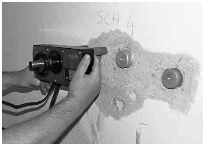
Obr. 6 Provedení zkoušky pevnosti v tahu povrchových vrstev pomocí trhacího přístroje DYNA DY-216 s plně automatickým nárůstem zatěžovací síly. Vpravo terče nalepené na povrch betonu.
