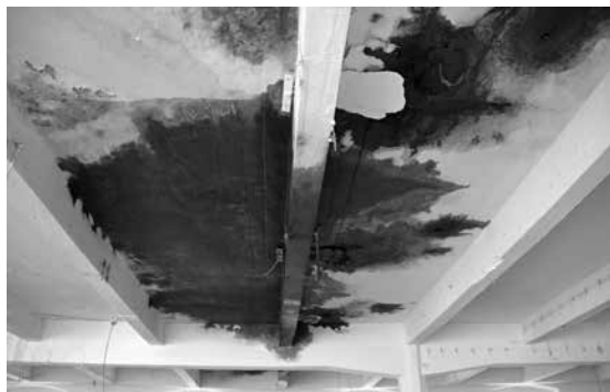
Obr. 18 Poškození stropní konstrukce provozem strojů v bývalé textilní továrně v Brně. Rozsáhlá část stropní konstrukce je kontaminována strojním olejem (konstrukce z roku 1928)
