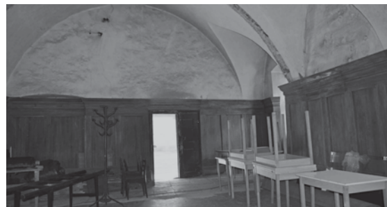
Nevyhovující stav interiéru
