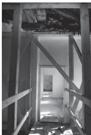
Nevyhovující stav konstrukcí
