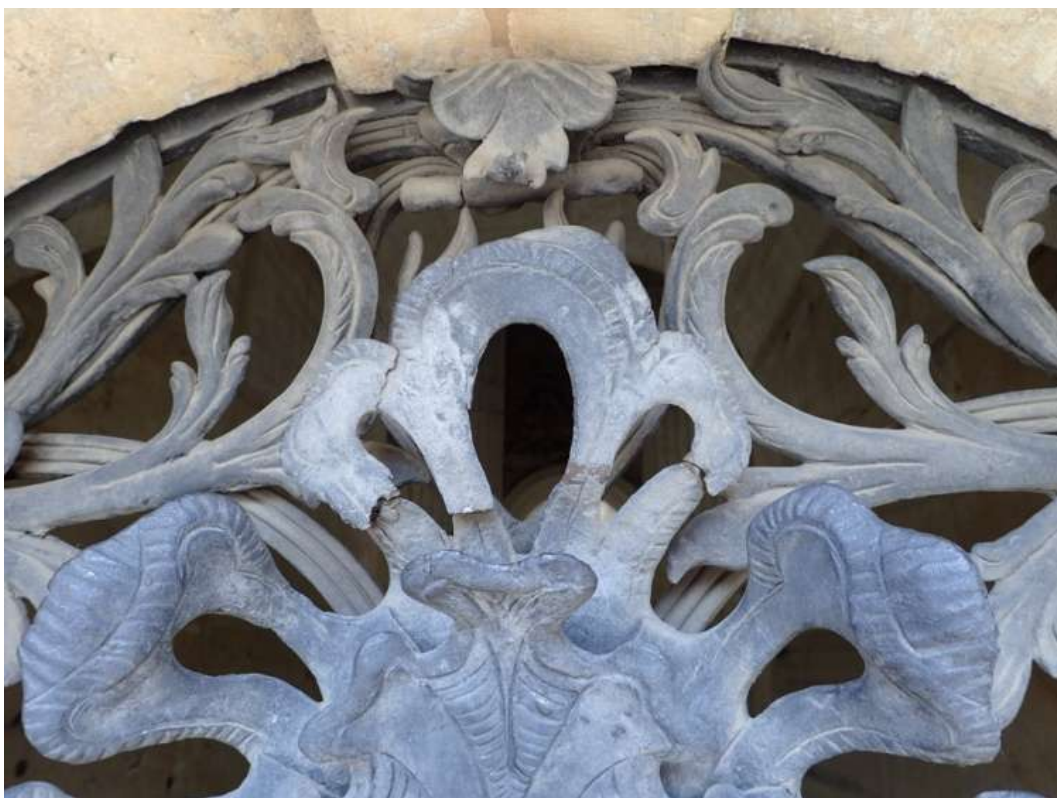
Obrázek 33: V horní lunetě mříže vstupu do kaple je mechanicky poškozená rokaj
