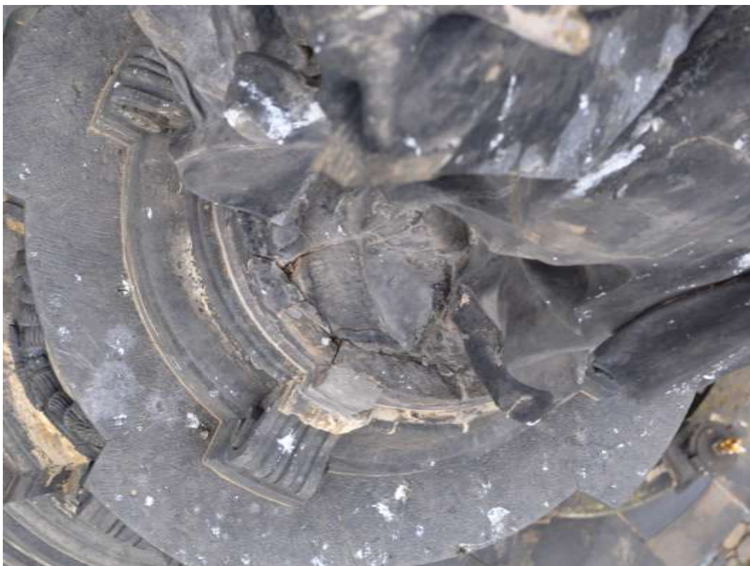
Obrázek 11: Třetí patro sloupu, socha sv. Anny, vrchní část plintu s poškozením
