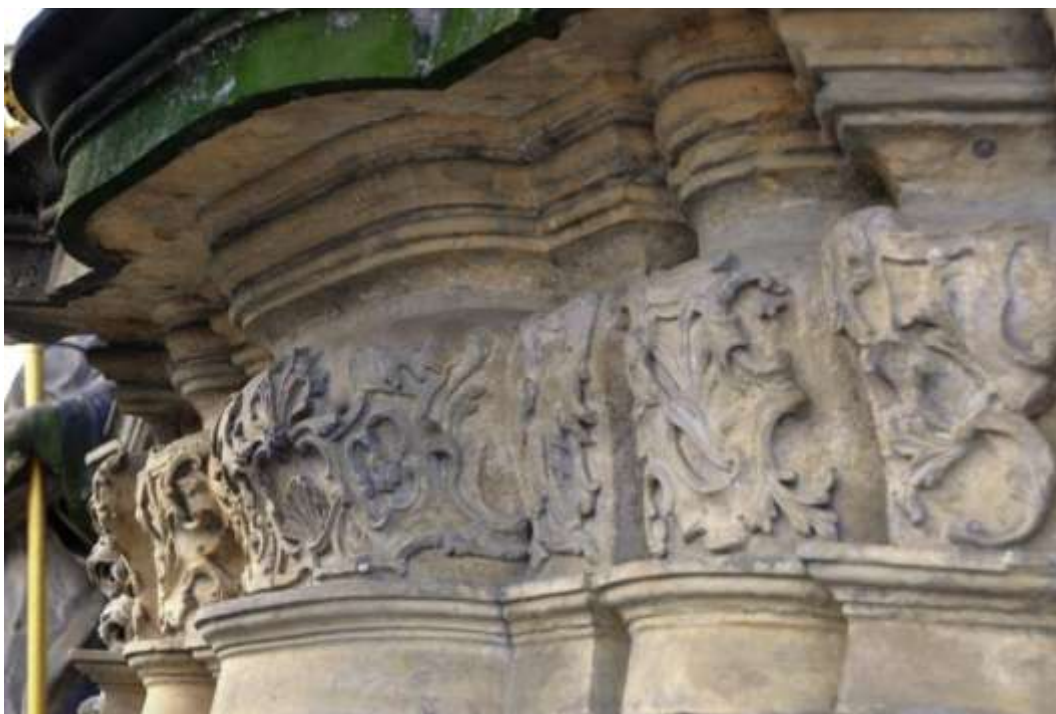
Obrázek 6: Vlys pod římsou druhého patra sloupu, povrch kamene je v těchto partiích narušen, na řadě míst jsou patrné výkvěty solí, na římsě je patrná masivní kolonizace řasou
