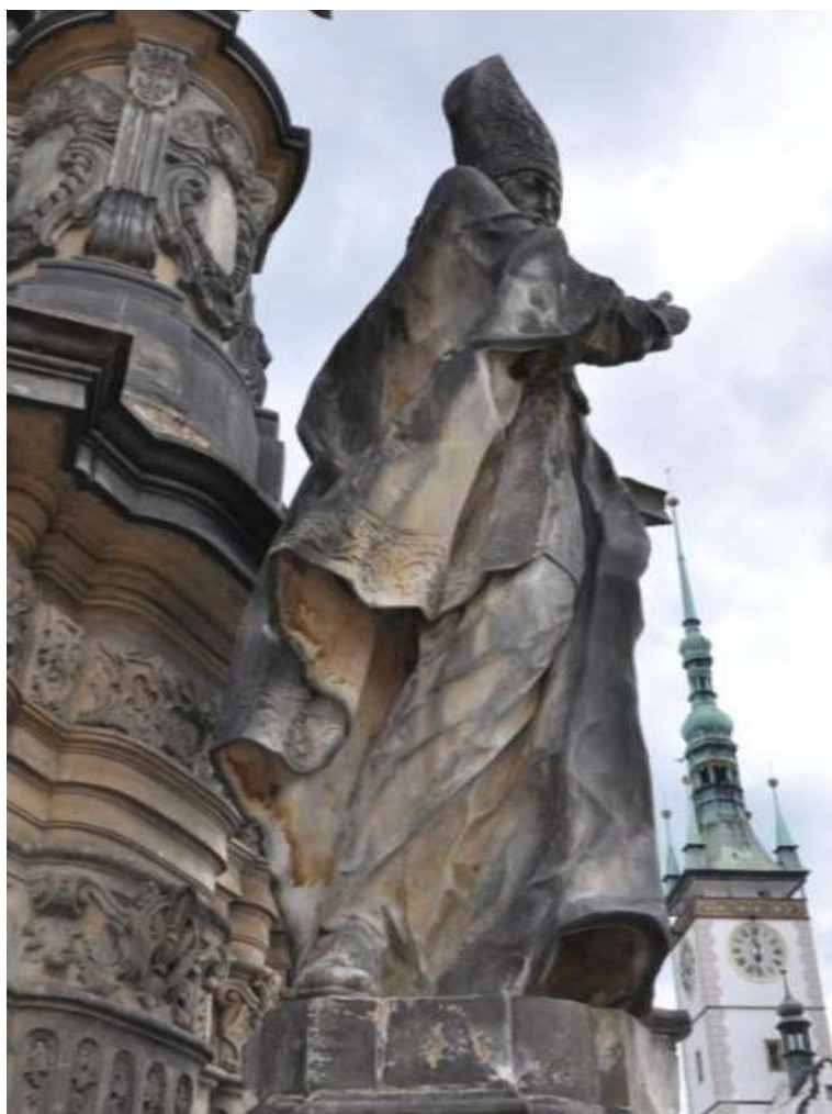
Obrázek 25: Druhé patro sloupu, socha sv. Blažeje, na rubu draperie je patrné zrzavohnědé znečištění degradačními produkty olejových nátěrů, které byly v minulosti odstraněny louhem a dosud migrují z nitra kamene na povrch
