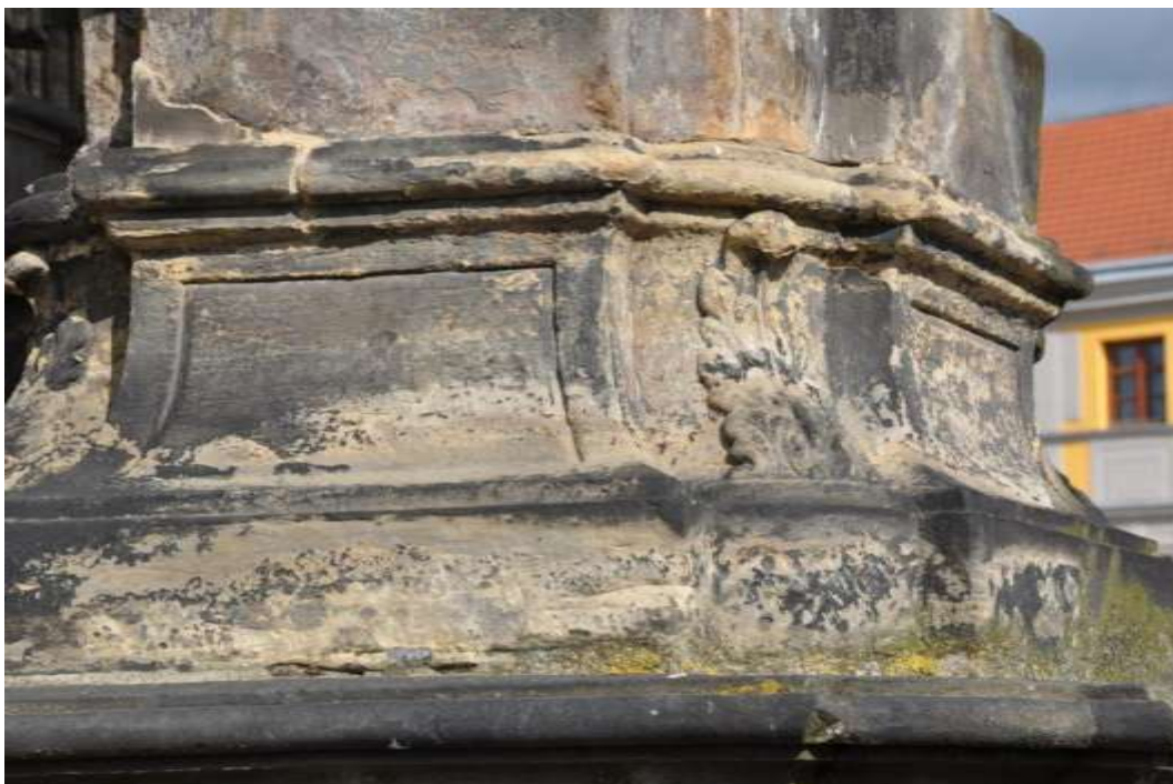
Obrázek 5: Druhé patro sloupu, podstavec sochy sv. Vojtěcha, silně narušený povrch kamene, k degradaci dochází zejména na subtilnějších partiích modelace vystupujících do prostoru, na degradaci se v tomto případě zřejmě podílela omezeně propustná křusta, která původně kryla celý povrch této části
