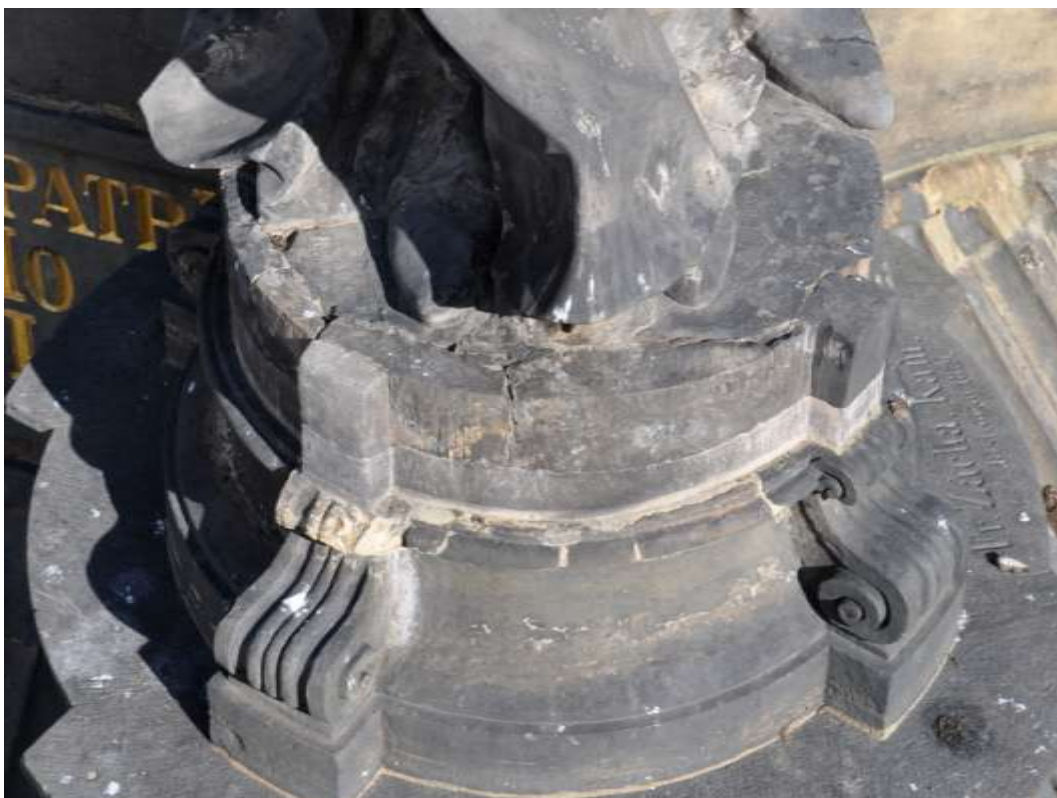
Obrázek 10: Třetí patro sloupu, socha sv. Anny, plintus s řadou hlubokých trhlin, oprava staršího poškození na tomto místě vyžaduje revizi
