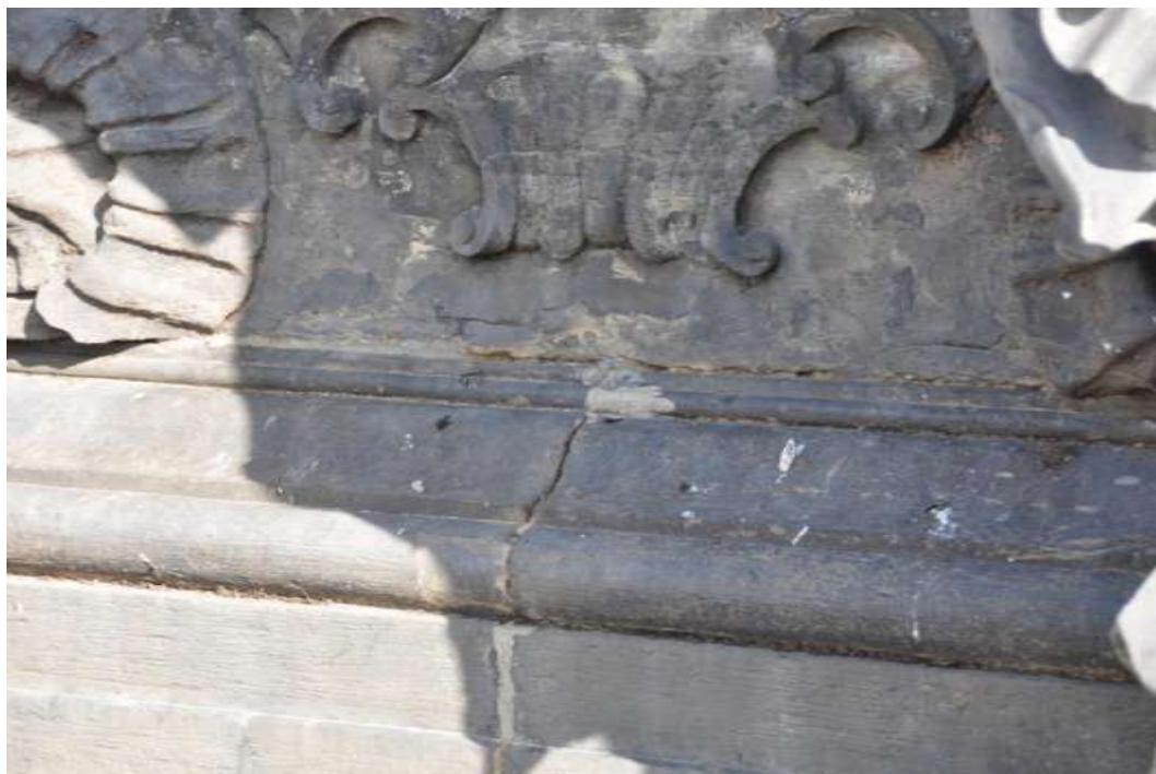
Obrázek 3: Třetí patro sloupu, detail architektury pod kartuší s reliéfem Víry, na mnoha místech architektury je vypadané spárování
