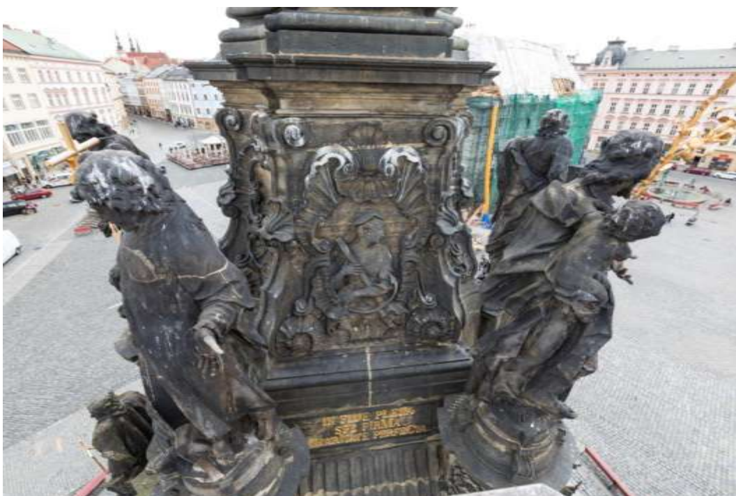
Obrázek 19: Třetí patro sloupu, v popředí sochy sv. Vavřince a sv. Josefa, hlavy a další části soch světců jsou podobně jako vystupující části architektury silně znečištěné ptačími exkrementy
