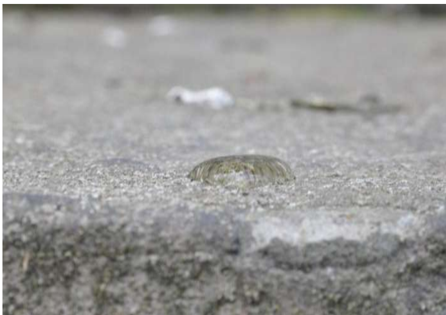
Obrázek 2: Kapka vody na horizontální ploše římsy druhého patra architektury dokumentuje, že povrch kamene je dobře smáčen vodou a již z větší části ztratil svoji hydrofobní úpravu, přesto je v daném místě nasákavost kamene omezená (kapka se nevsakuje)
