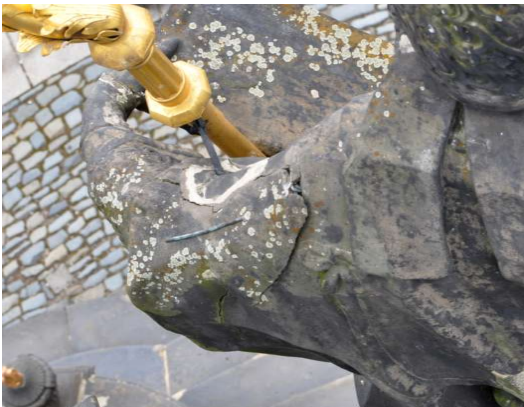
Obrázek 16: Druhé patro sloupu, socha sv. Metoděje, detail poškození v blízkosti ukotvení berli
