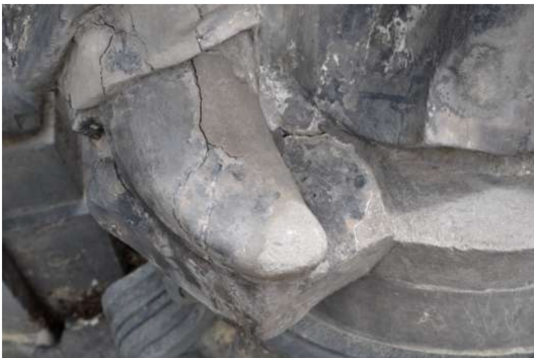
Obrázek 14: Třetí patro sloupu, socha sv. Jáchyma, prasklinou je narušen také výběžek plintu, o který se noha světce opírá
