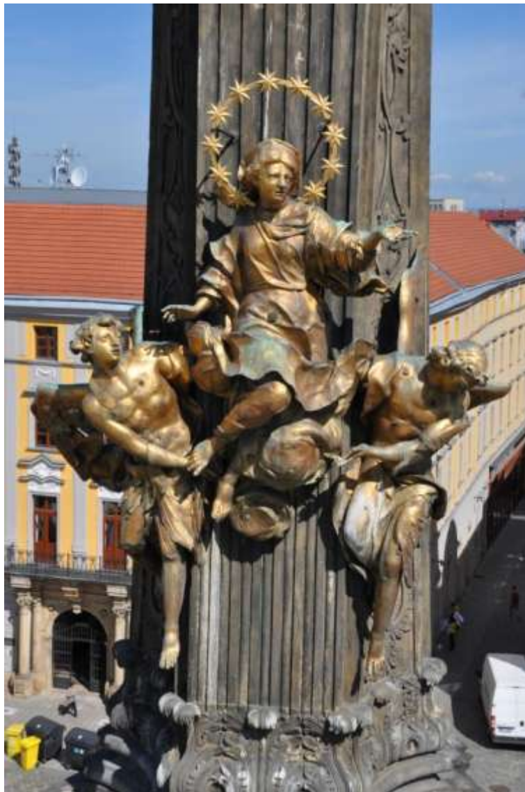
Obrázek 27: Sousoší Nanebevzetí Panny Marie, poškození se i v tomto případě projevuje nejvíce v estetické rovině, závažnější poruchy nebyly nalezeny
