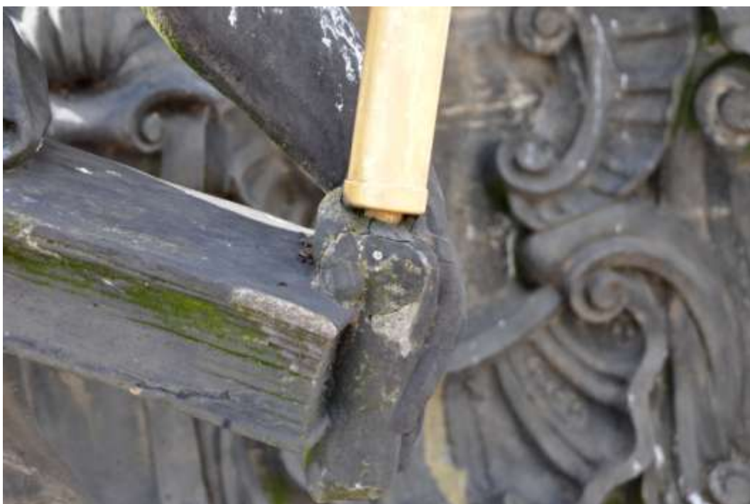
Obrázek 17: Třetí patro sloupu, socha sv. Jeronýma, detail poškození v místě ukotvení křížifixu
