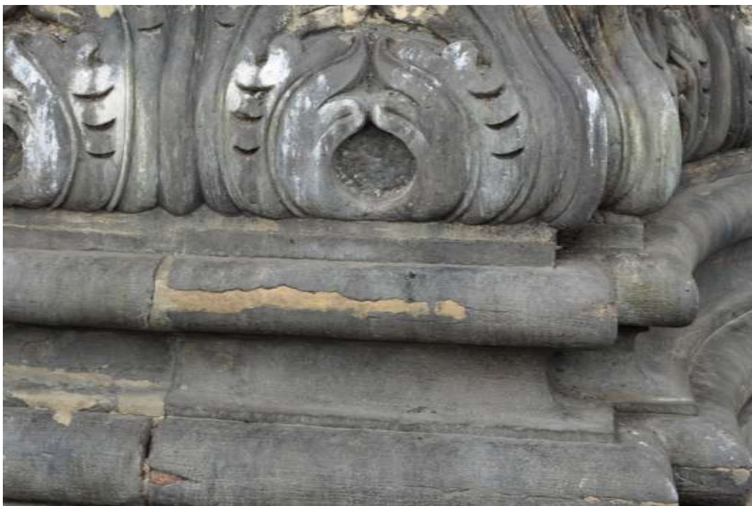
Obrázek 9: Patka pylonu, hojně drobné lokální opravy trhlin kamene jsou již také bez patinace
