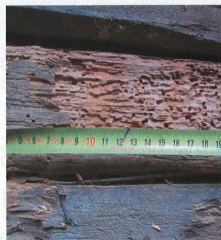
▲ Obr. 7 Ilustrace míry poškození dřeva
