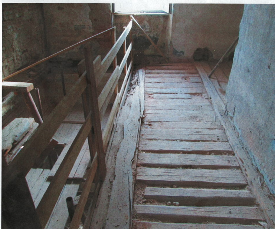
▲ Obr. 3 Původní stav Pluhovských domů (strop napadený dřevomorkou)
