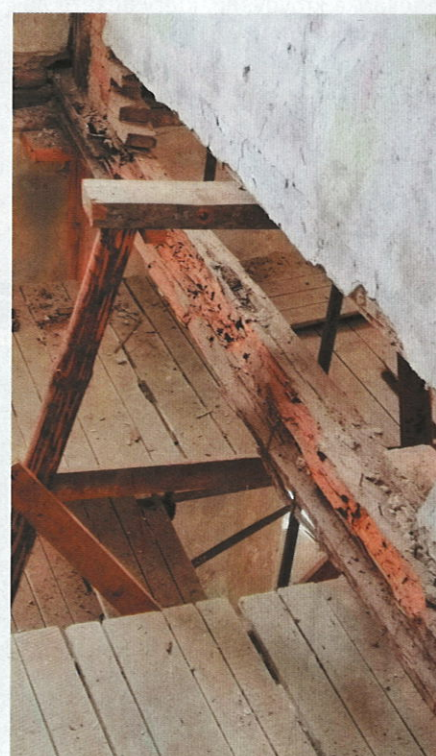
▲ Obr. 4 Ilustrace míry poškození stropů
